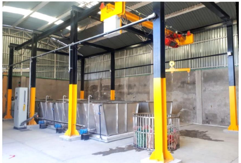
Planta de Tratamiento Hidrotérmico
